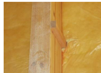
吊杆部分的隔热材料缺口
