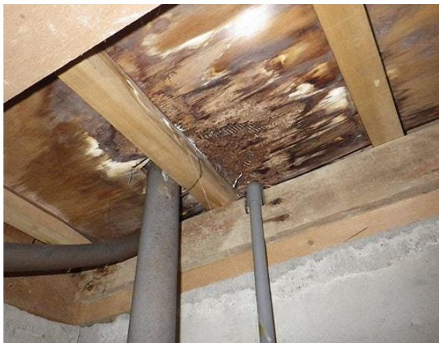
建35年后 浴室地板下部的腐朽（胶合板）
