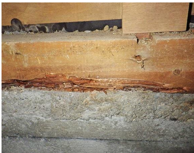
建35年后 浴室地板下部的腐朽（地梁）
