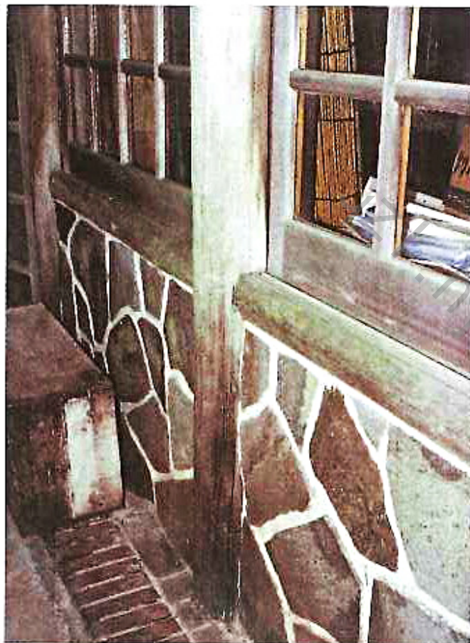
路边服务站（建筑24年）外露的柱脚部分受雨水影响腐朽
